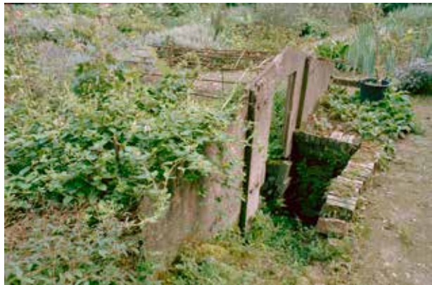
Arnhem, buitenplaats Menthenberg, vervallen verdiepte kas van deels prefab beton, foto J.P. de Koning 2002, no. 344.900 Collectie RCE.
