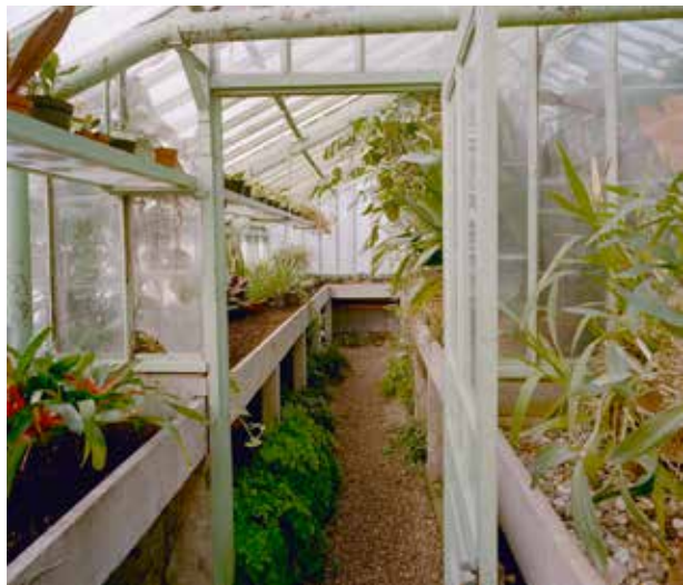
Beetsterzwaag, het Lycklamahûs, betonnen tabletten in de warme kas, J.P. de Koning 2002, no. 342.454 Collectie RCE. De compartimentering is goed te zien.
