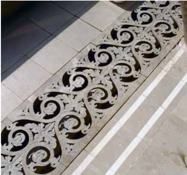
Terwolde, buitenplaats De Matanze, gietijzeren verwarmingsrooster in de vloer van de wintertuin, die gelegen is op de verdieping van het huis, foto A.J. van der Wal 2003, no. 312.433 Collectie RCE.
