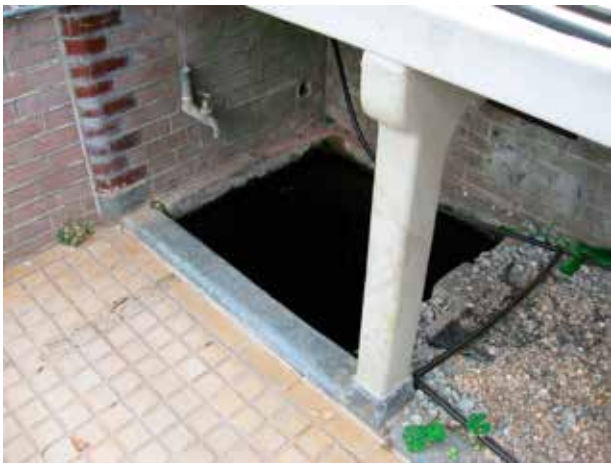
Utrecht, Oude Hortus, collectiekas, waterbak onder de betonnen tabletten, foto B.H.J.N. Kooij 2006, Collectie RCE. Bij tabletkasten is dikwijls naast of onder de tabletten een waterbak gemaakt. Het binnenkomende regenwater kan geleidelijk de temperatuur van de kasruimte aannemen.
