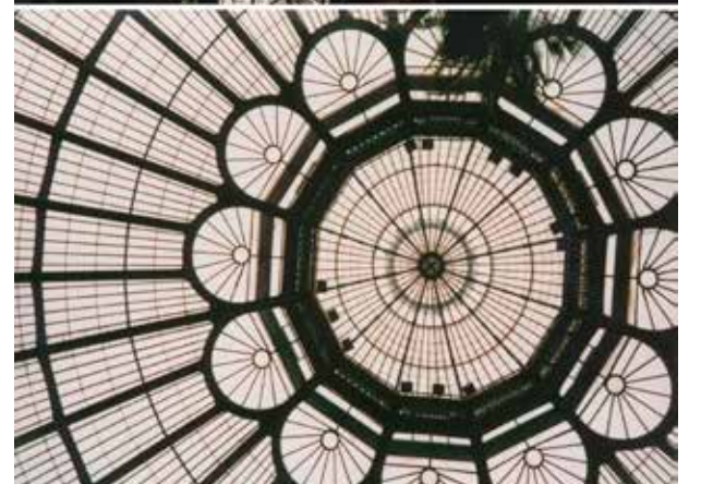
Drie voorbeelden van toegepaste drukringen bij de constructie van kassen. Van boven naar beneden: Amsterdam, de palmenkas (1912); Rotterdam, diergaarde Blijdorp (1937 - 1940) en Brussel, de Wintertuin (1874 - 1879) in de paleistuin. Foto 1, G.J. Dukker 2001, no. 339.614, foto 2 (2000) en foto 3 (1998) B.H.J.N. Kooij, Collectie RCE.
