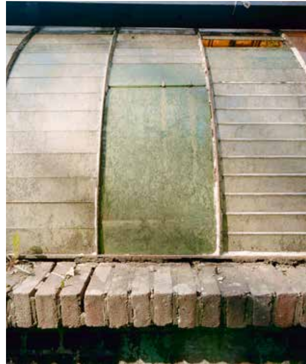
Oranjewoud, buitenplaats Oranjestein, detail van het glasdek vóór de restauratie, foto IJ.Th. Heins 2001, no. 346.225 Collectie RCE. In het midden originele ronde ruiten en ter weerszijden hiervan noodreparaties. Het glas was met stopverf vastgezet. Na de restauratie zijn er weer ronde ruiten geplaatst.
