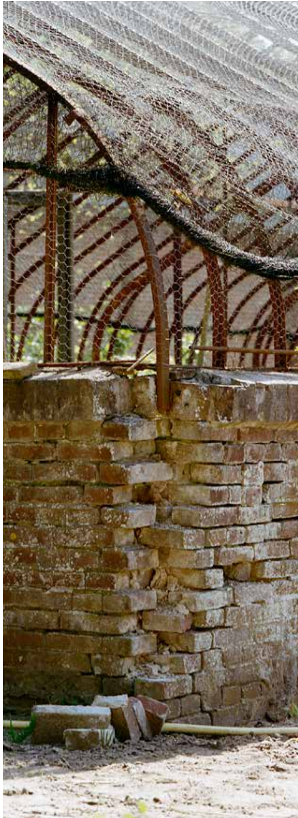
Vogelenzang, buitenplaats Vogelenzang, hoekdetail van losgeraakt metselwerk van de tabletkas in de moestuin, foto IJ.Th. Heins 2003, no. 346.202 Collectie RCE. Jarenlange inwatering en roestvorming hebben het metselwerk ontzet.
