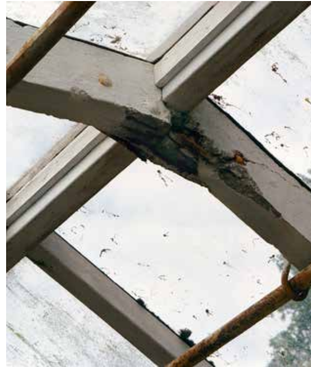
Almelo, buitenplaats Bellinckhof, Wierdensestraat 206, schade aan de spanten van de betonnen kas in de moestuin, foto IJ.Th. Heins 2003, no. 334.670 Collectie RCE.
