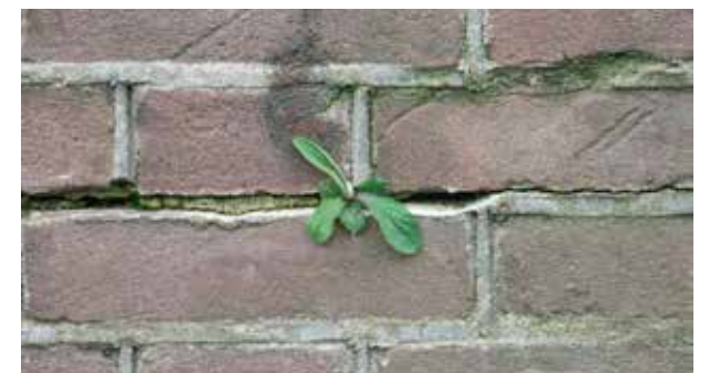
Utrecht, de Oude Hortus Botanicus, beschadigd voegwerk waardoor vocht gemakkelijk in het metselwerk dringt, foto M. van Hunen 2005, Collectie RCE.
