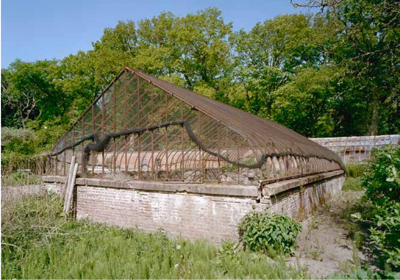
Functieverlies: Vogelenzang, Huis te Vogelenzang. Deze prachtige ijzeren tabletkas heeft geen functie meer en vervalt in snel tempo, IJ.Th. Heins 2003, no. 346.198 Collectie RCE. Ofschoon deze waardevolle kas al lange tijd niet meer onderhouden is, verkeert het ijzerwerk toch nog in een redelijke conditie die restauratie mogelijk maakt. Negentiende-eeuws ijzerwerk is over het algemeen van goede kwaliteit en goed te restaureren.
