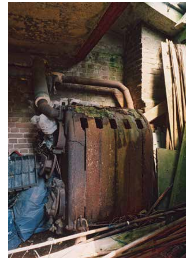
Laren (N-H), buitenplaats Larenberg, vervallen verwarmingsketel, foto IJ.Th. Heins 2003, no. 346.745 Collectie RCE. Herstel is niet meer mogelijk.
