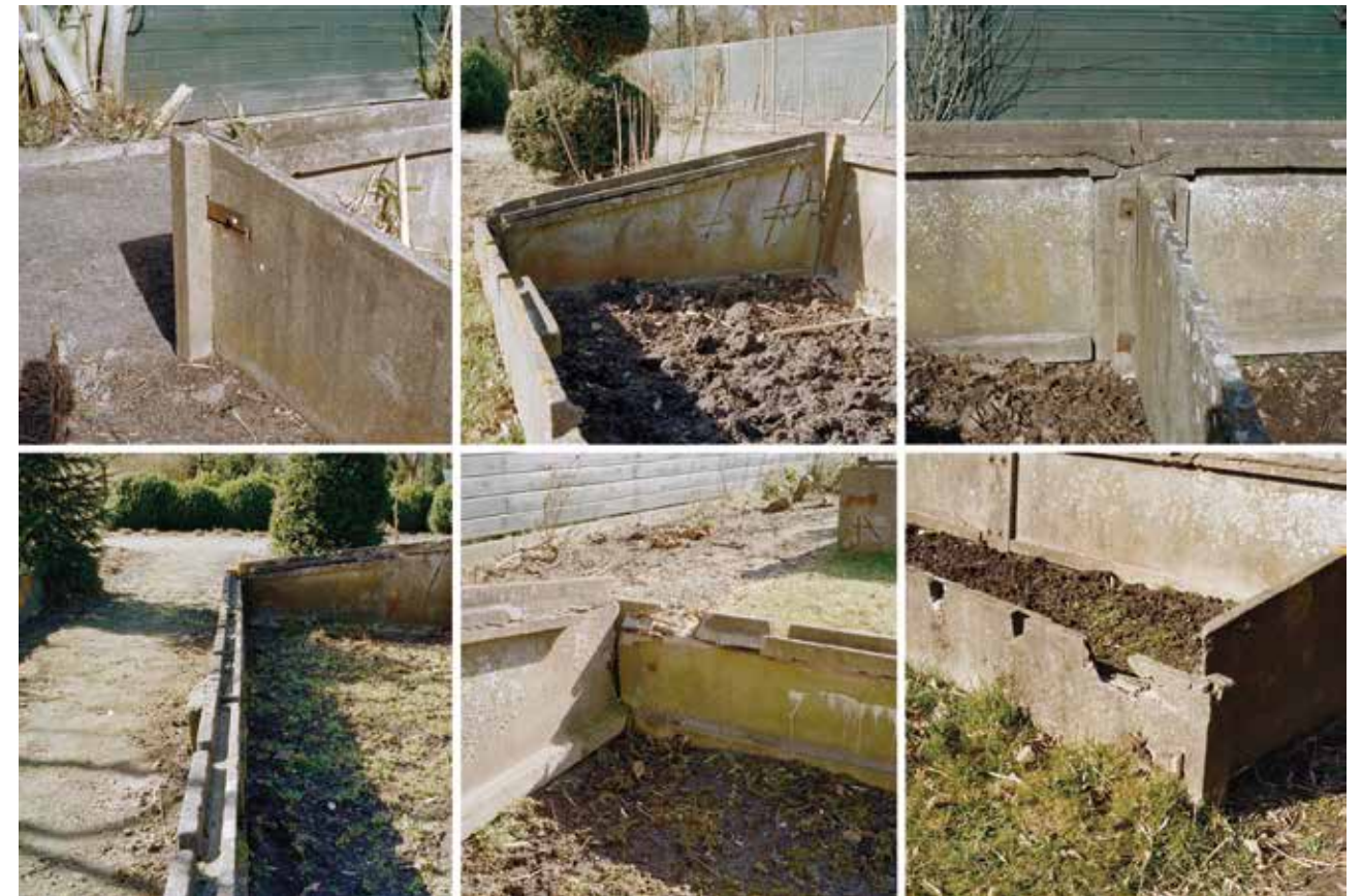
Wassenaar, buitenplaats Zuydwijk, zes opnamen van details van de vroege prefab betonnen bakken waar de schade goed waarneembaar is, foto IJ.Th. Heins 2003, no. 356.962 (roest en scheurvorming), 356.969 (wapening bloot), 356.960 (roesten van wapening), 356.968 (waterhol onderrand), 356.963 (afbrokkeling beton) en 356.959 (beton afgevroren) Collectie RCE.
