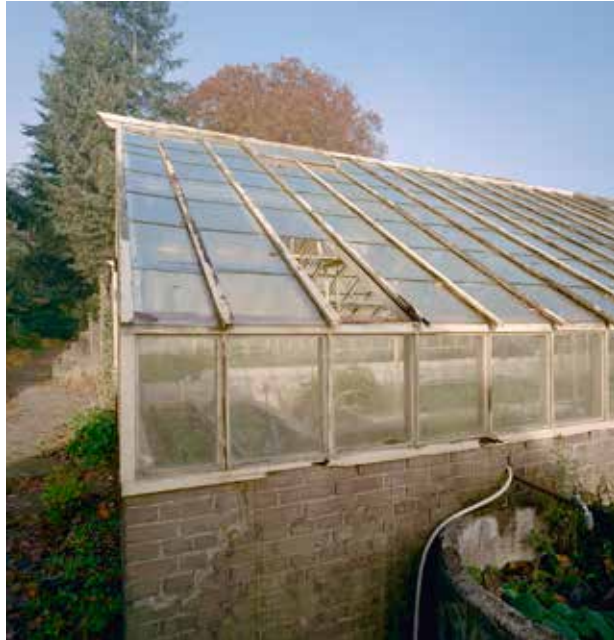
Empe, Huis Empe, schade aan het houtwerk van de tabletkas ten gevolg van slecht onderhoud en slechte detaillering, foto J.P. de Koning 2001, no. 338.773 Collectie RCE. Mogelijk speelt ook de kwaliteit van het hout uit eerder onderhoud een rol.
