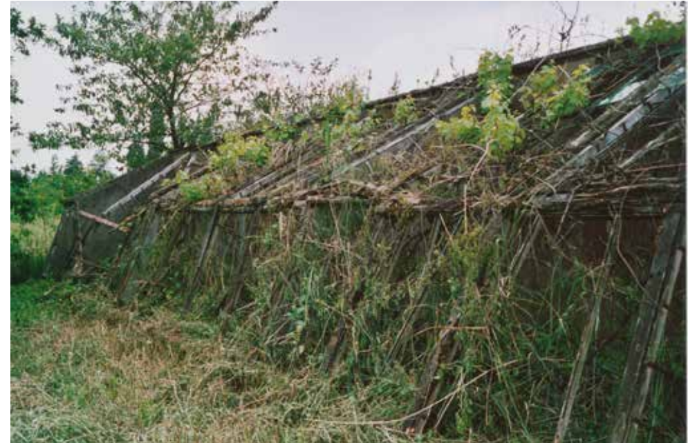
Nieuwersluis, buitenplaats Middenhoek, muurkas met veel achterstallig onderhoud, foto B.H.J.N. Kooij 2005, Collectie RCE. Vrijwel al het houtwerk van deze gebroken lessenaar zal hier vervangen moeten worden. In dergelijke gevallen is het aan te raden de kas met de constructie en zijn details goed vast te leggen.
