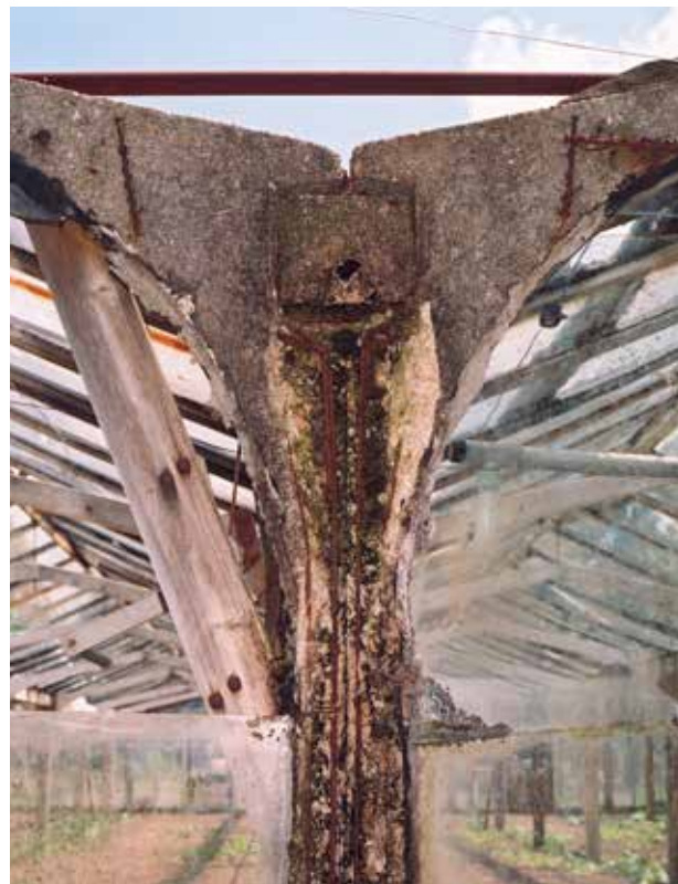
Rijsoord, Rijksstraatweg 54, detail bovenzijde kassen met blootliggende wapening, foto IJ.Th. Heins 2003, no. 334.636 Collectie RCE.
