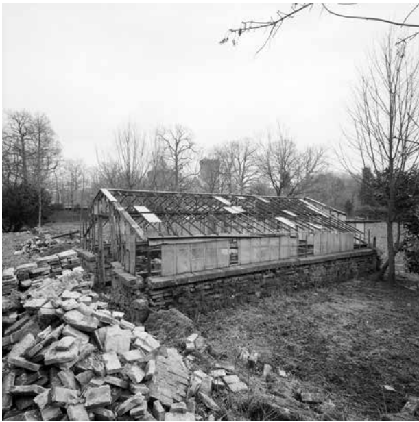
Driebergen, kasteel Sterkenburg, vervallen tabletkas, foto J.P. de Koning 2001, no. 337.829 Collectie RCE. Op de achtergrond is nog net het kasteel te zien. De staat van onderhoud van deze kas gaat het groot onderhoud te boven. Hier is een grondige restauratie nodig.
