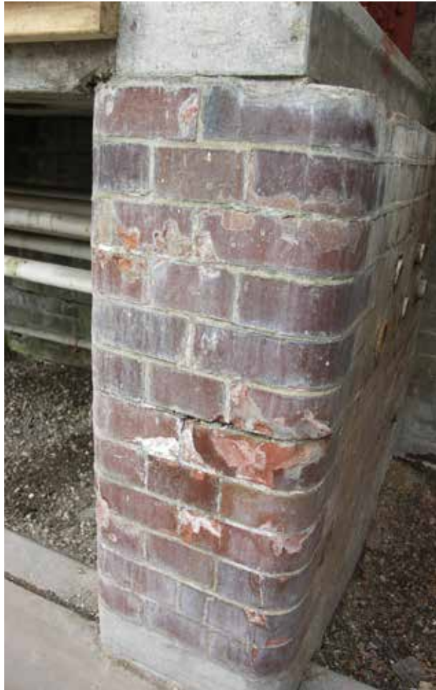
Utrecht, de Oude Hortus Botanicus, zoutschade aan metselwerk, foto M. van Hunen 2005, Collectie RCE. Tijdens droging van het metselwerk worden zouten naar het oppervlak gevoerd en veroorzaken daar tijdens uitkristalliseren schade.
